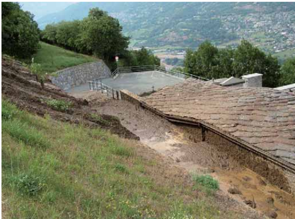
La frana di Primaz scesa lungo il muro perimetrale del cimitero
