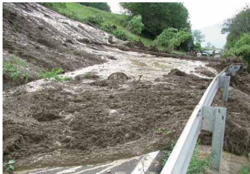
La frana di Primaz abbattutasi sulla strada regionale
