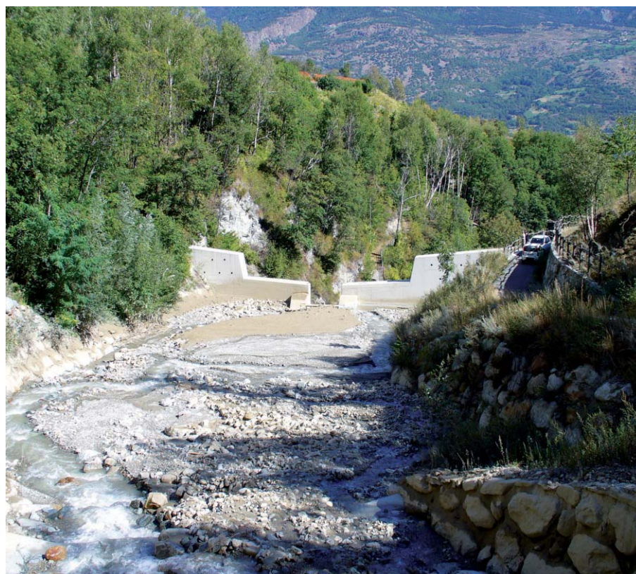
Il bacino di accumulo colmo di materiale dopo l'evento
