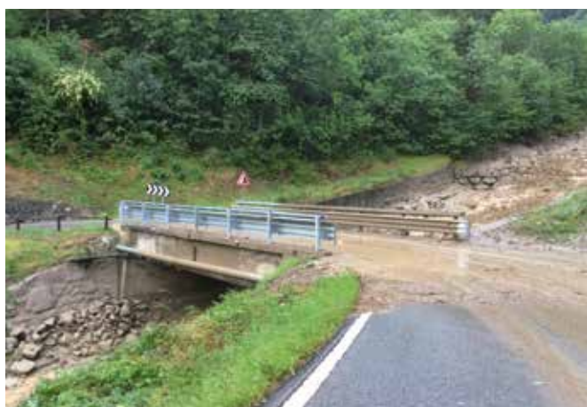
Nubifragio – Il ponte sul torrente Laures a monte della briglia.
