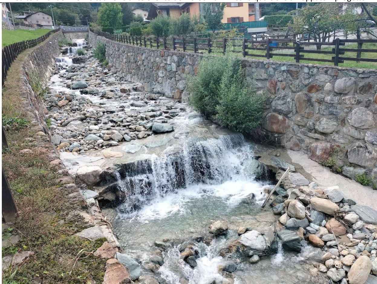
Salto di fondo n. 8 – Situazione attuale – importante approfondimento dell'alveo
