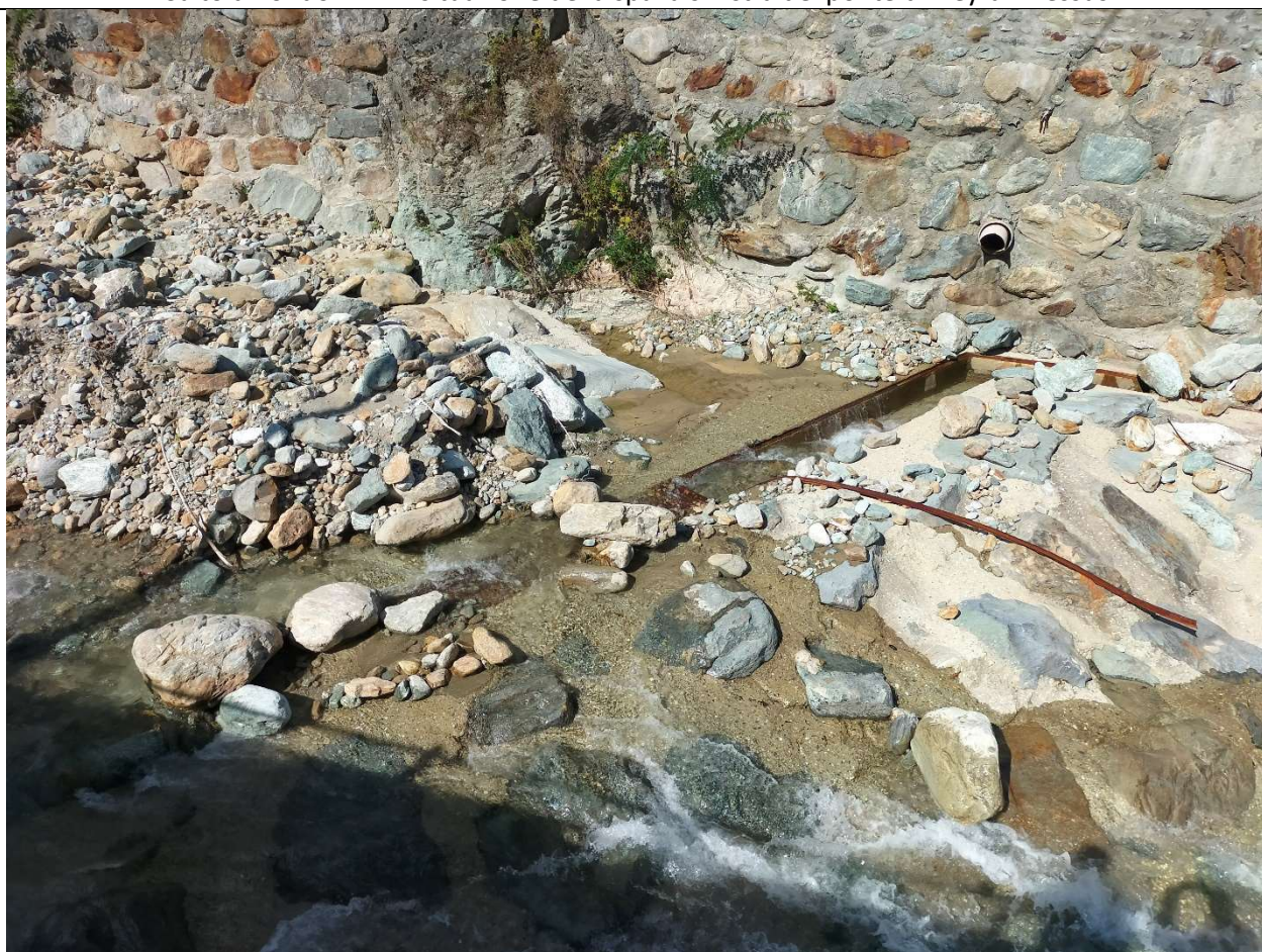
Opera di presa del ru riempita dal materiale e danneggiata con asportazione struttura in ferro
