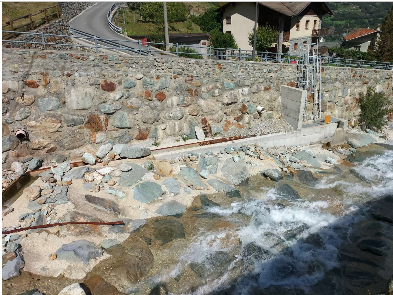
Opera di presa del ru da ripristinare con pulizia e nuove griglie
