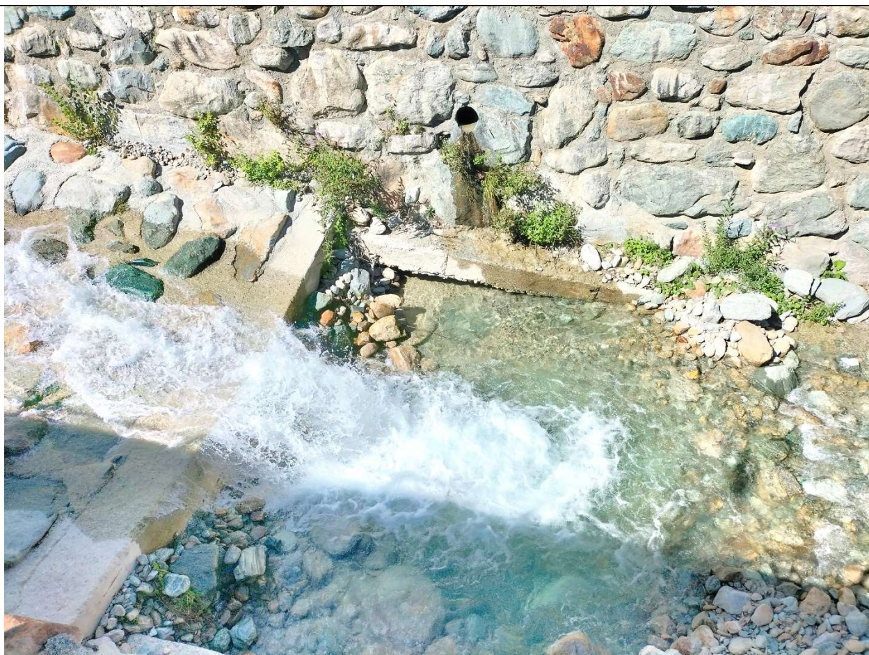
Salto di fondo n. 12 a monte del ponte di Neyran Dessus - a valle del taglione il fondo è stato eroso e le fondazioni murarie sono state messe in luce
