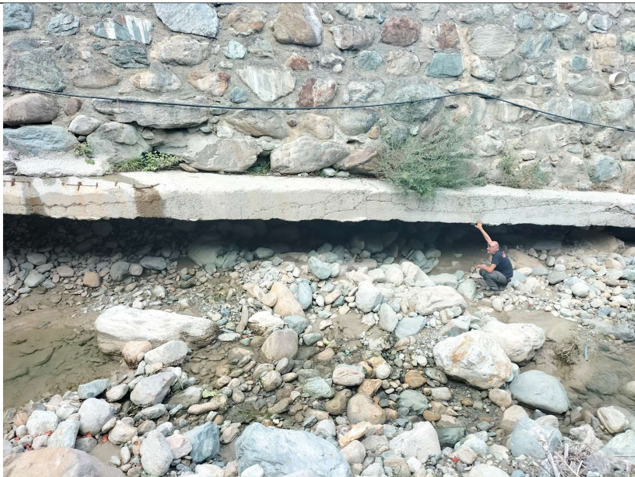
Salto di fondo n. 6 – Situazione attuale –sottoescavazione delle fondazioni in sponda sinistra.
