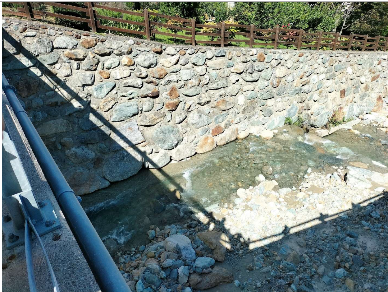
Salto di fondo n. 12– situazione della spalla sinistra del ponte di Neyran Dessus
