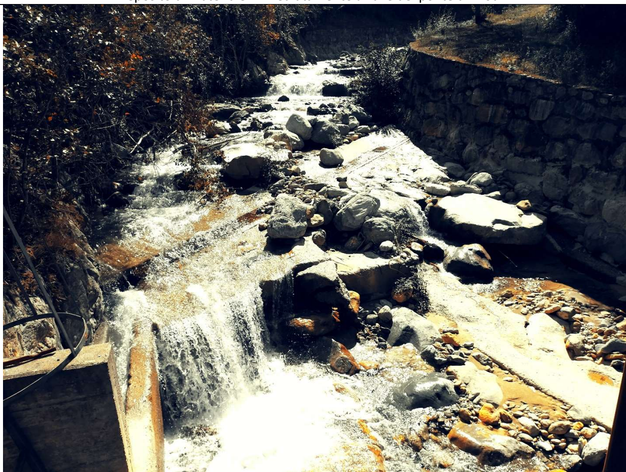
Salto n. 16 a monte del ponte di Moulin – parzialmente danneggiato
