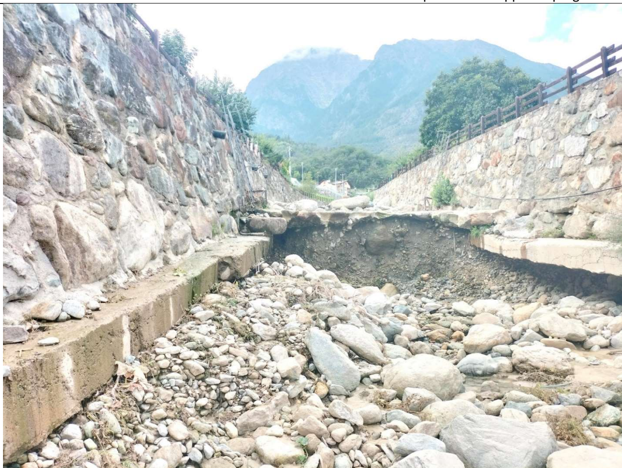
Salto di fondo n. 6 – Situazione attuale – profonda erosione a valle del salto e sottoescavazione delle fondazioni.
