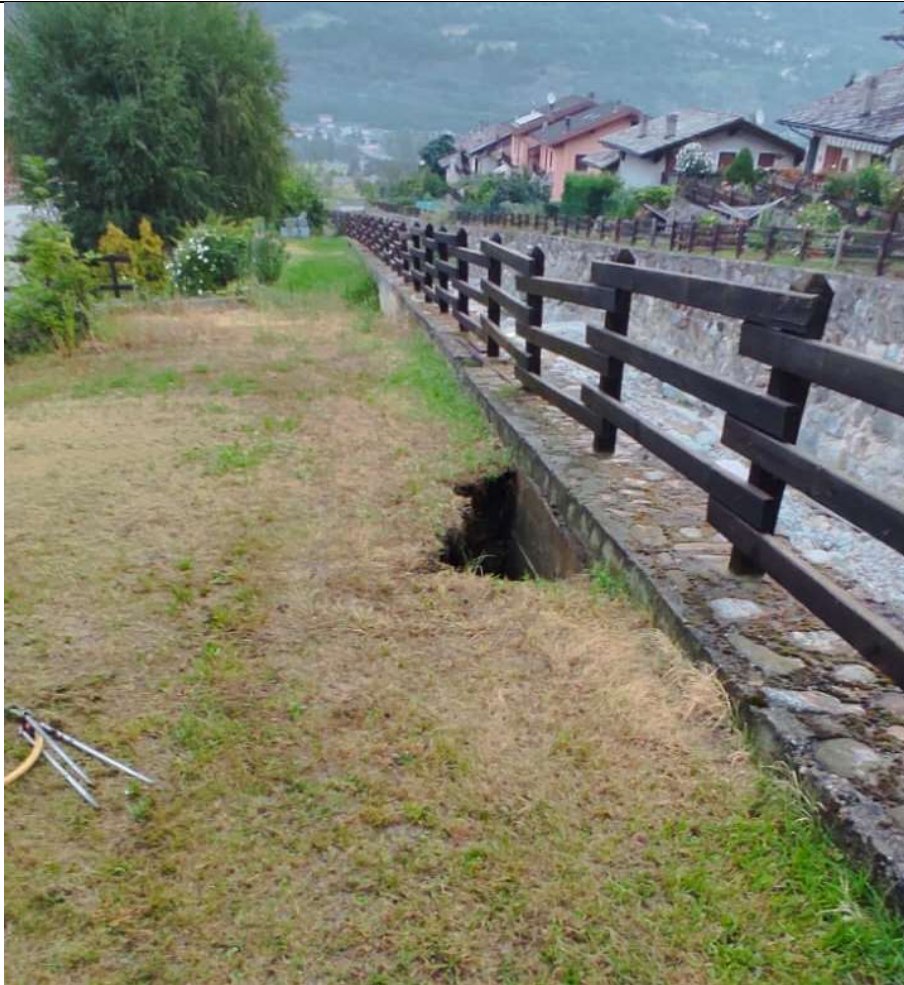
Voragine che si è formata sulla sponda sinistra in corrispondenza della sottoescavazione delle fondazioni.
