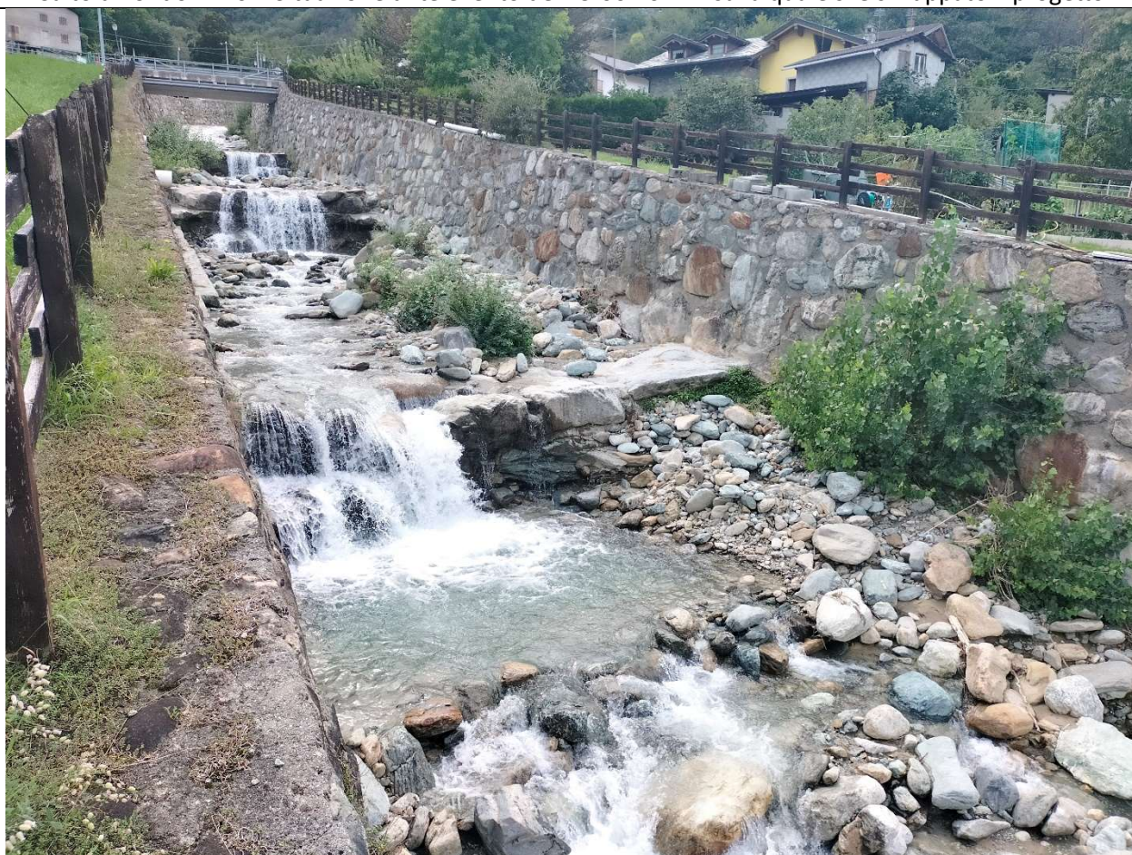
Salto di fondo n. 10 – Situazione attuale – formazione di buca a valle del salto e asportazione di materiale
