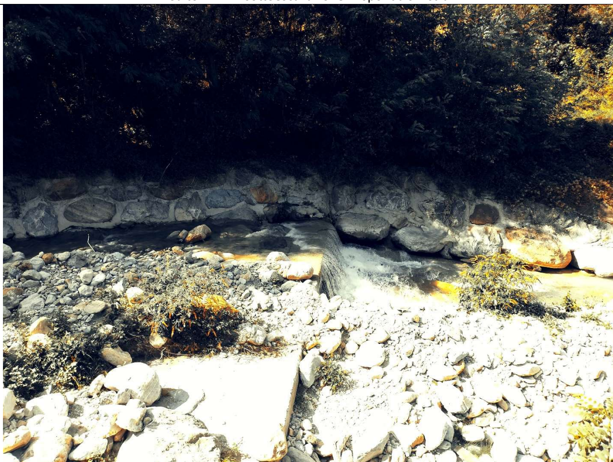
Salto n. 15 – erosione del piede della scogliera in sponda sinistra
