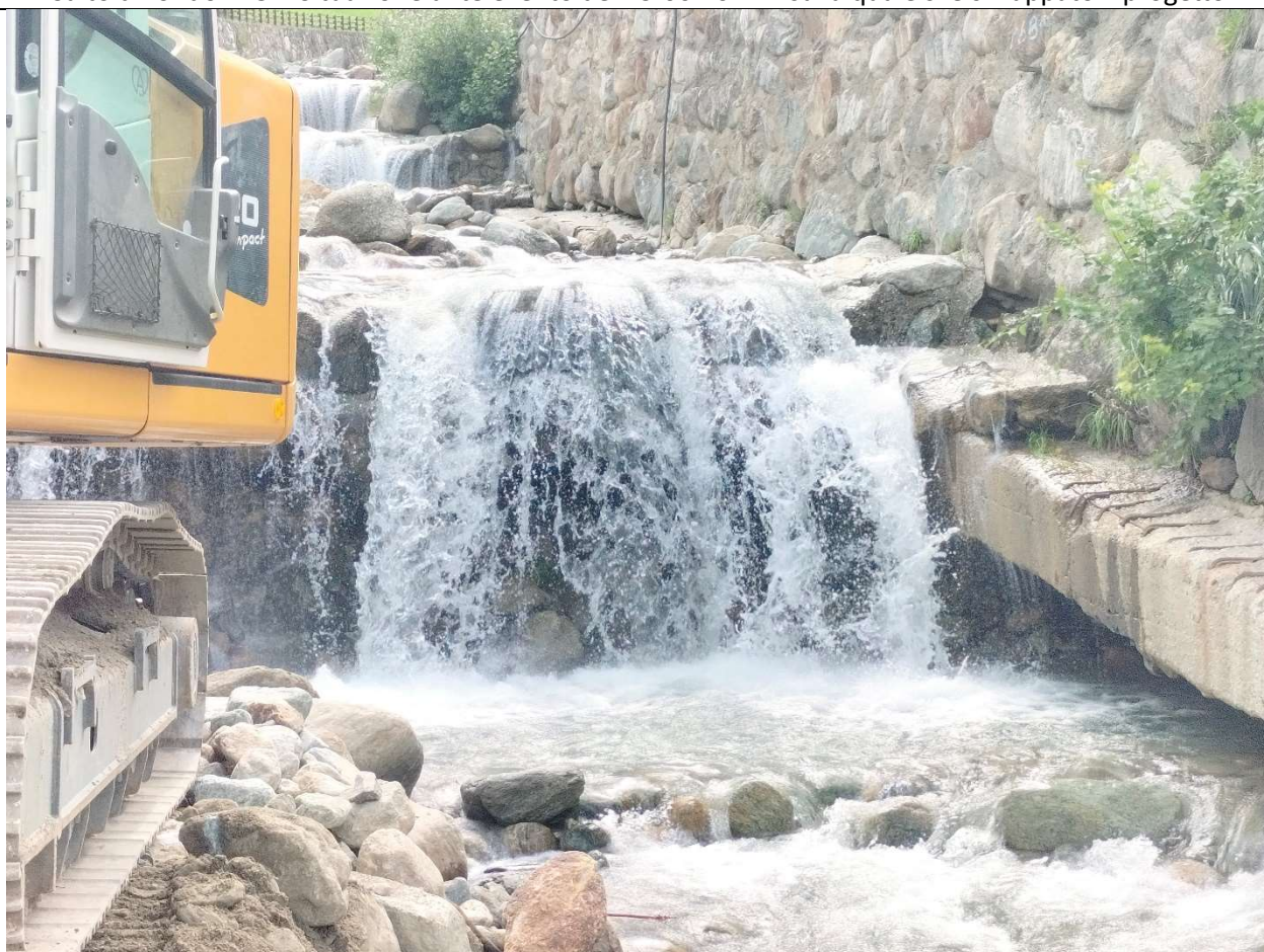
Salto di fondo n. 5 – Situazione attuale – profonda erosione del fondo con asporto di materiale
