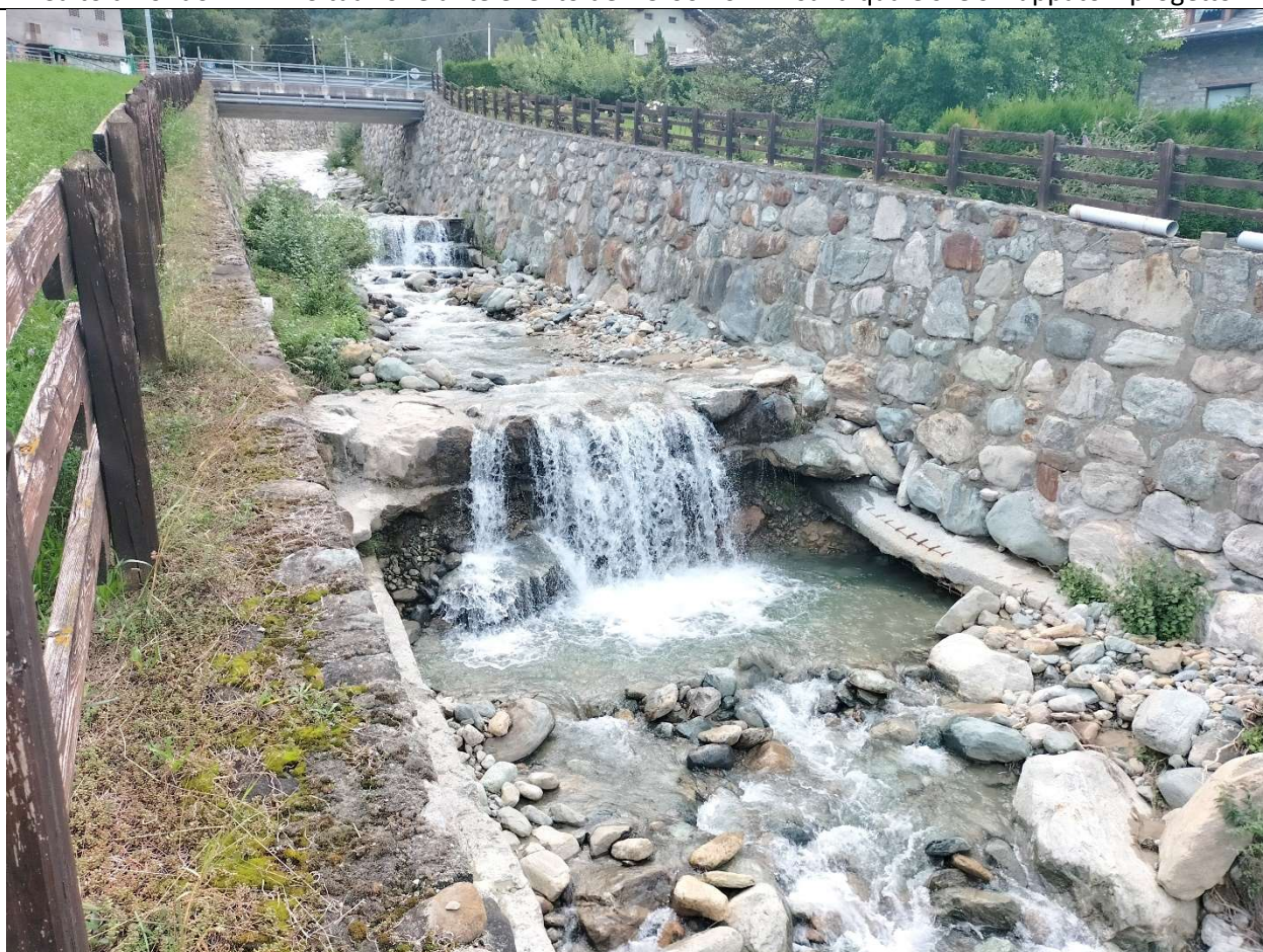
Salto di fondo n. 11 – Situazione attuale – formazione di buca a valle del salto e asportazione di materiale
