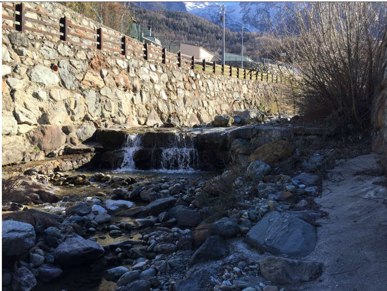
Salto di fondo n. 8 – Situazione ante evento del 29.06.2024 – sulla quale si è sviluppato il progetto
