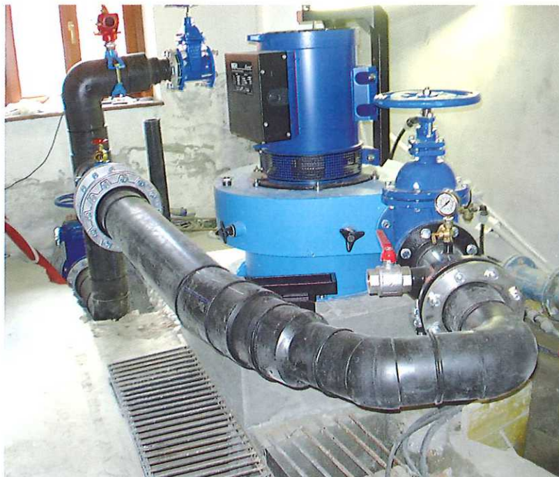
La nuova turbina a servizio dell'alpeggio e del bivacco Laures
