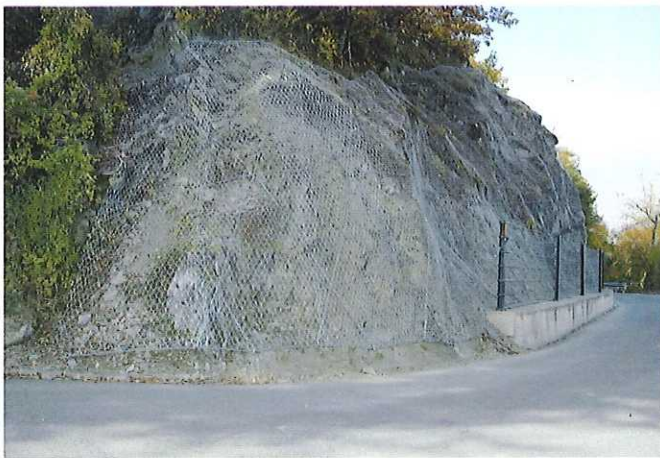
La rete metallica posizionata per evitare la caduta di pietre
